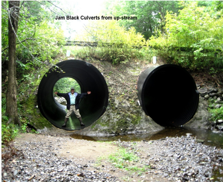
sediment above culverts.)
